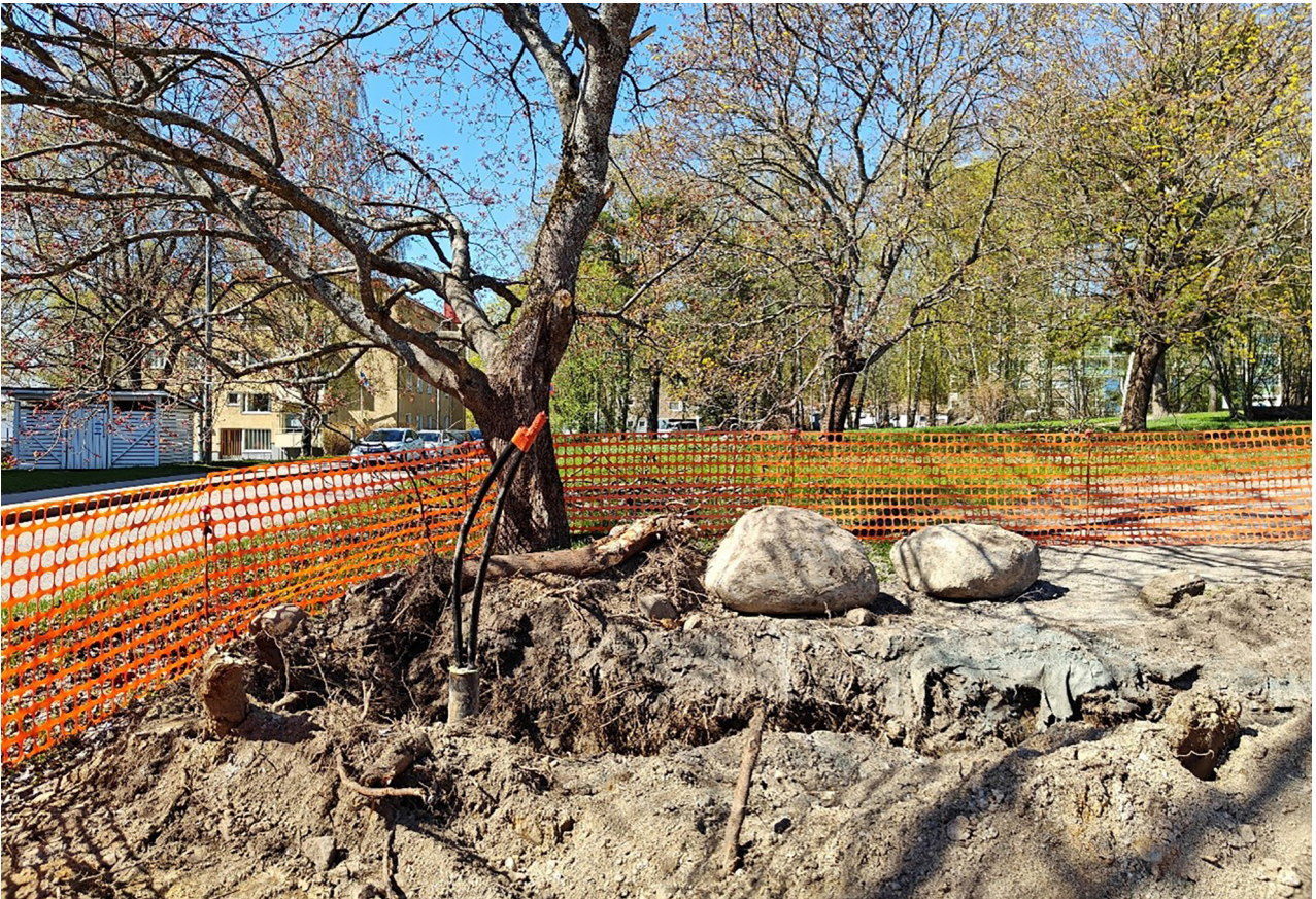
Kuva 31. Keruuputkiston kaivanto on tehty liian lähelle säilytettäväksi tarkoitettua puuta. Puun runkoa ja sen juuristoa ei ole suojattu rakennustöiden ajaksi.
