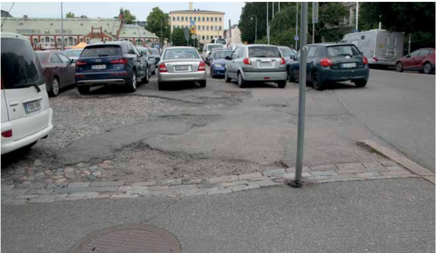
Kuva 134, alla. Hietalahdentorin päällysteet ovat erittäin huonokuntoiset. Vanhaa kenttäkiveystä on päällystetty asfaltilla – hyvin todennäköisesti ainakin osassa asfaltoitua torialuetta alla on vanha kenttäkiveys. Torin ja kadun reuna on epäselvä, sillä sitä ei ole rajattu reunakivellä. Toripinta on kuoppainen ja autot peittävät torialueen yli avautuvia näkymiä. Hyvin huonokuntoiseksi päässyt torialue heikentää alueen arvoja. LP.
