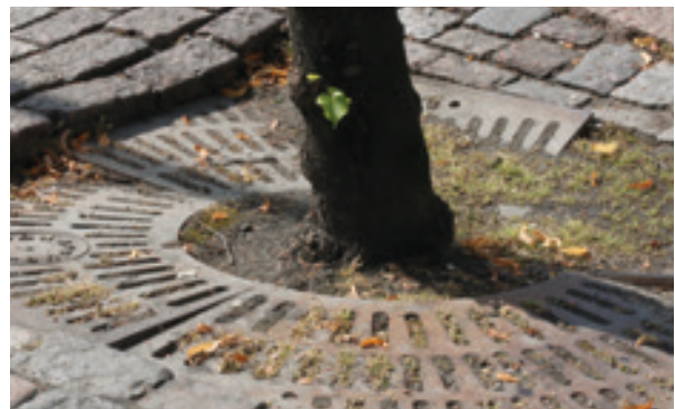
Paikoin rakenteet ovat huonokuntoisia. Tässä näkyy painunut ja haljennut juurisuoja.
