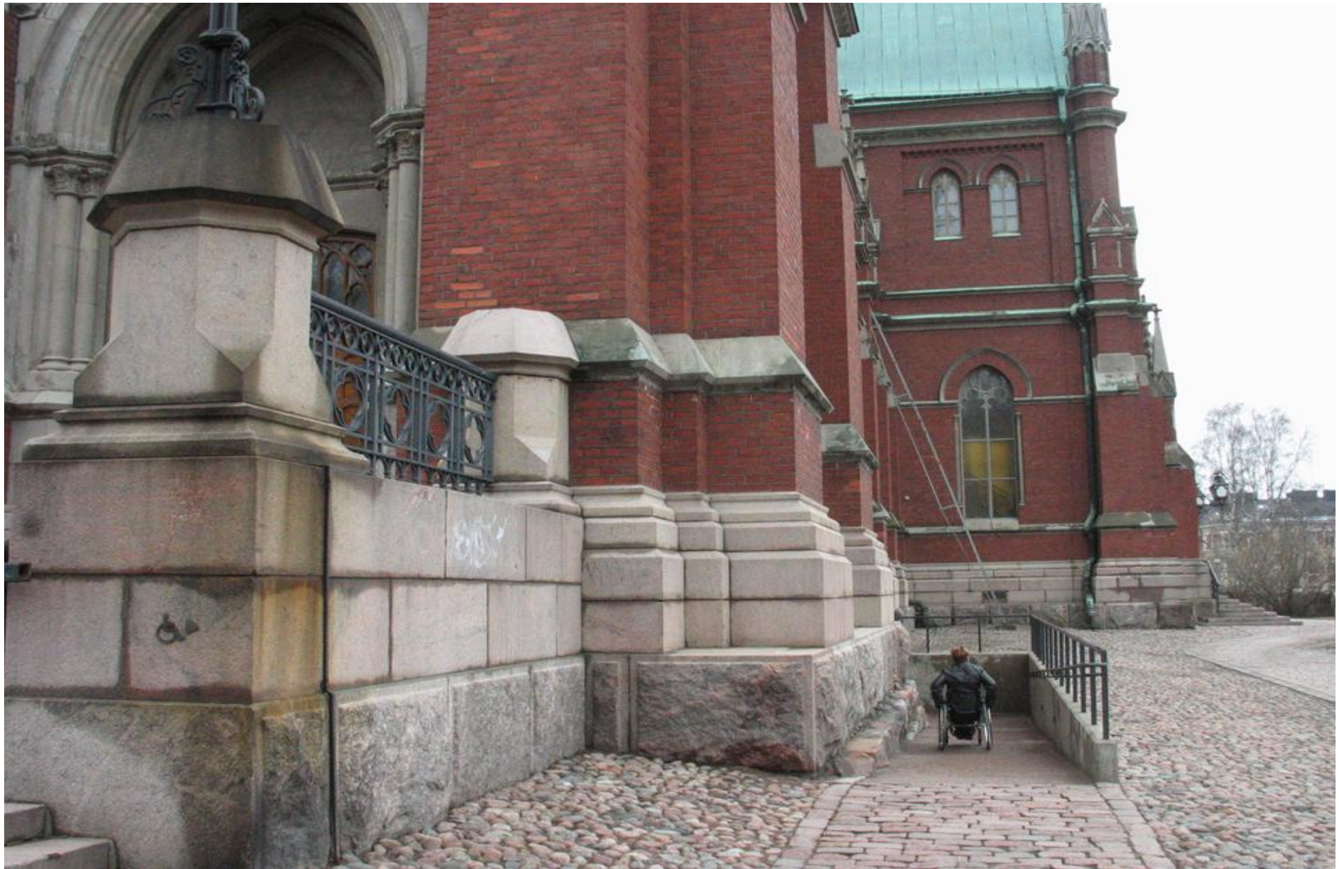
3. Rampen leder neråt till samma nivå som kyrkans nya krypta. Rampen är uppvärmd och avloppsförsedd för att fungera även under vinterförhållanden. (Johanneskyrkan)
