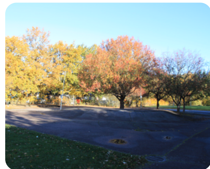
Kuva 83. Asfalttipintaisessa keskusaiheessa on painumia
