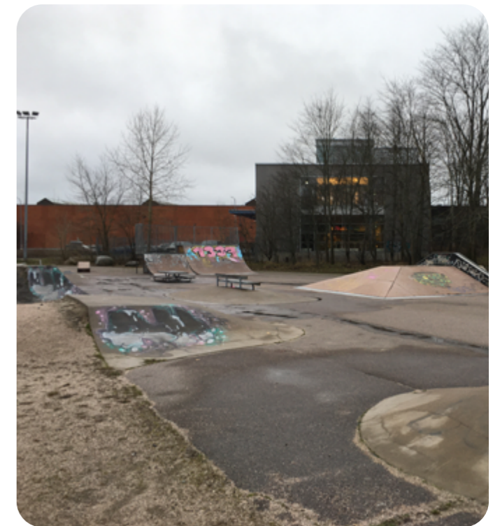
Kuva 59. Kartanonhaan skeittipaikan kuluneita rakenteita ja pinnoitteita
