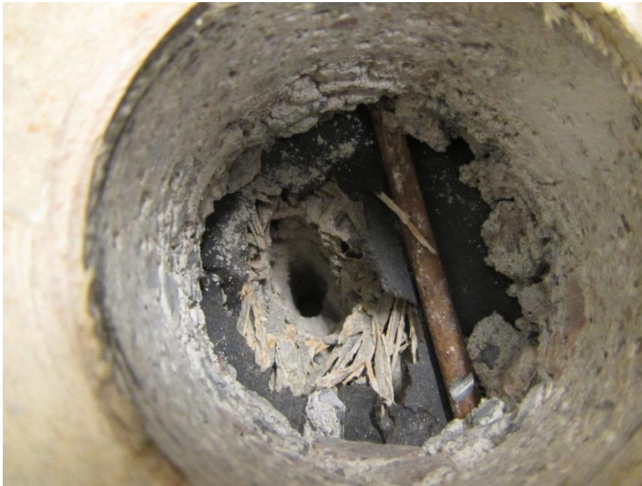
Kuva 13. Koulurakennuksen välipohjarakenteen tervapaperi sisältää PAH-yhdisteitä ja bentso-a-pyreeniä. (Näyte WMY 3)
