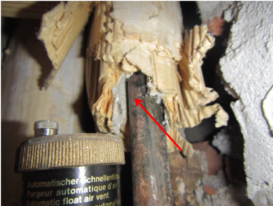
Kuva 10. Aaltopahvinen putkieriste, jonka sisäpinnassa on harmaa massa, sisältää asbestia (krysotiili). (Näyte WMY 19)
