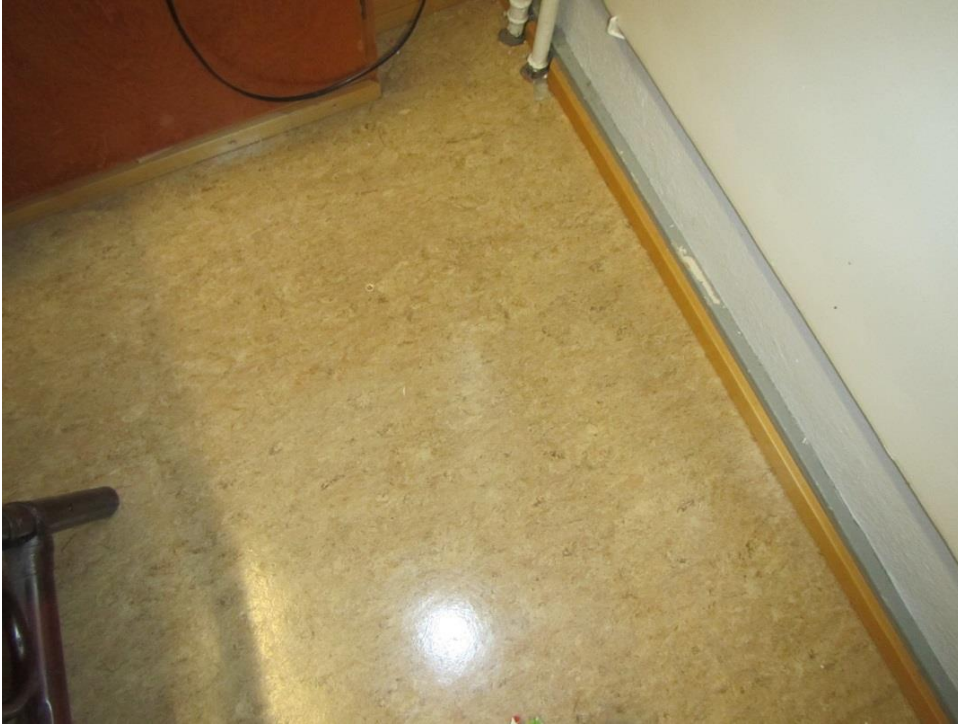
Kuva 28. Beige linoleumimatto sisältää haitallisen määrän sinkkiä (WMY 27).
