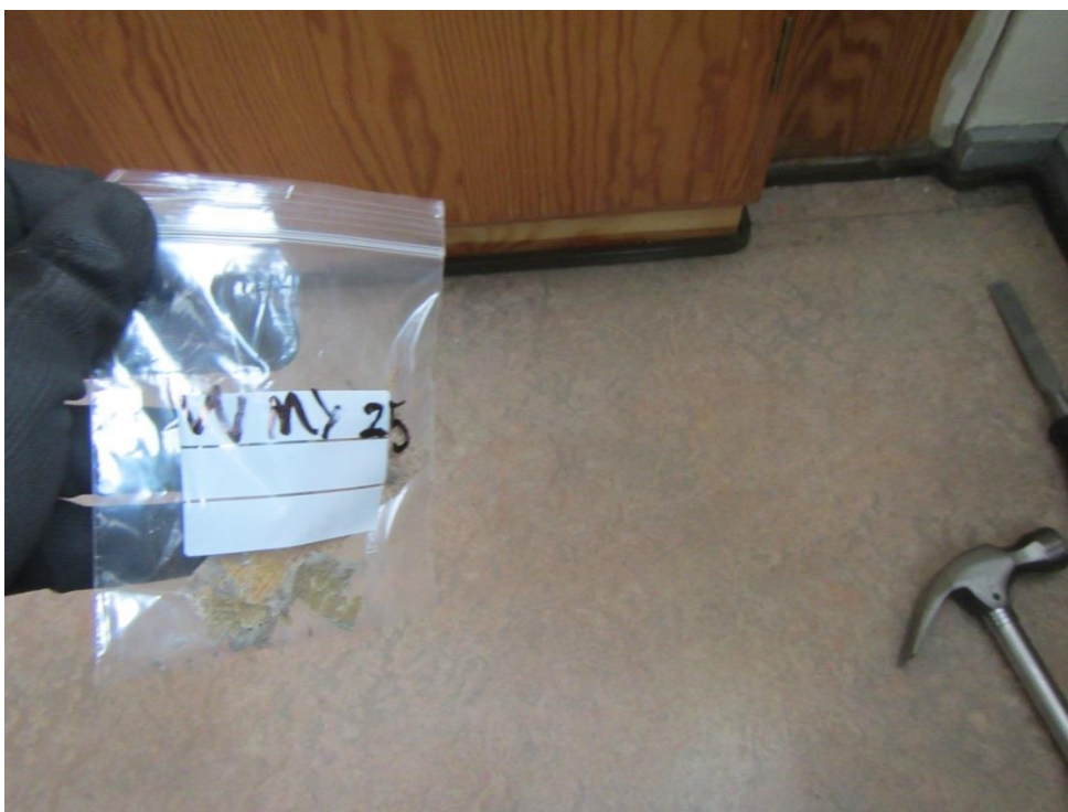
Kuva 27. Vaaleanpunertava linoleumimatto sisältää haitallisen määrän sinkkiä (WMY 25).
