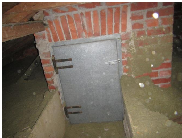
Kuva 11. Palo-ovi PO2 saattaa sisältää asbestia.
