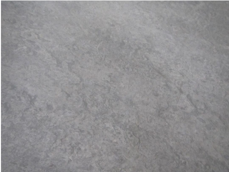
Kuva 26. Vihertävä-harmaa linoleumimatto sisältää haitallisen määrän sinkkiä (WMY 24).
