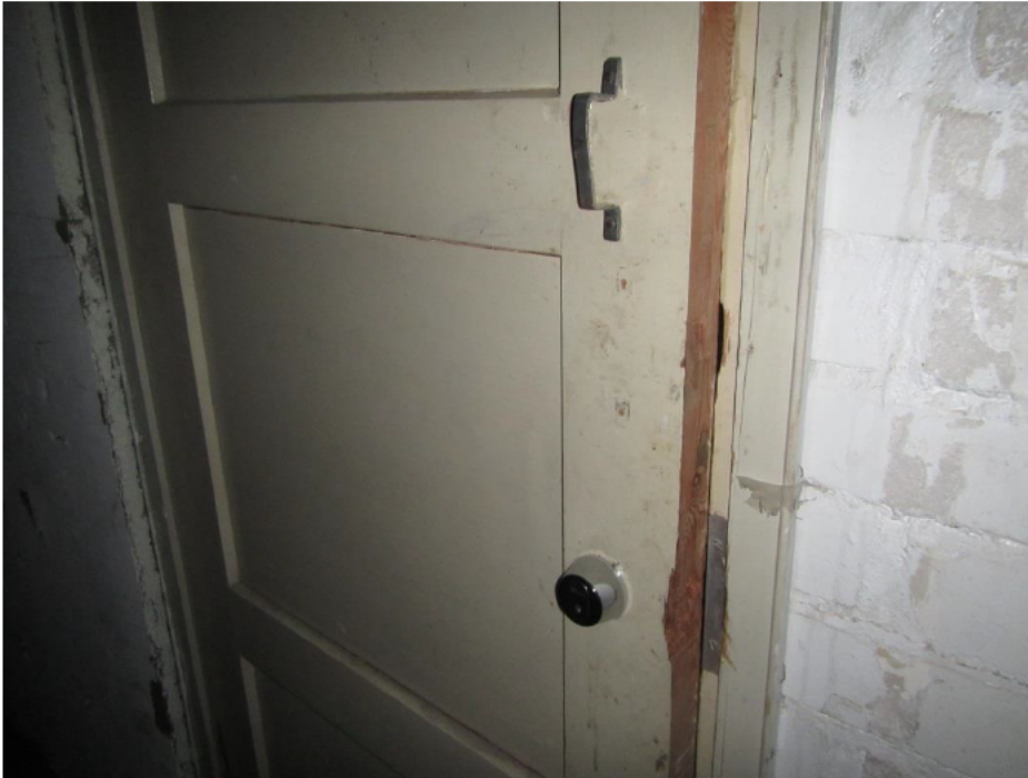
Kuva 36. Koulurakennuksen kellarin puuvien vaaleanbeige maalipinta sisältää haitallisen määrän sinkkiä (WMY 60).
