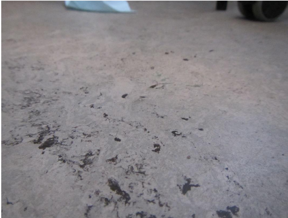
Kuva 20. Vaaleanruskea mustatäpläinen marmorikuviainen linoleumimatto sisältää haitallisen määrän lyijyä (WMY 13).
