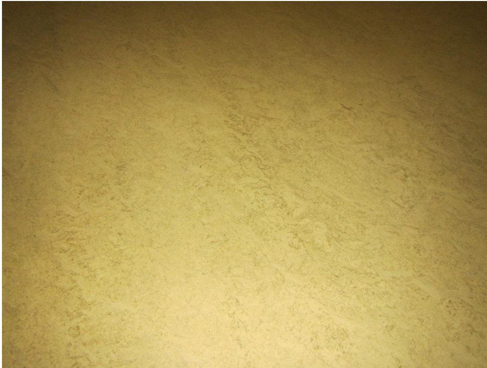
Kuva 24. Keltainen marmorikuviainen linoleumimatto sisältää haitallisen määrän lyijyä ja sinkkiä (WMY 20).
