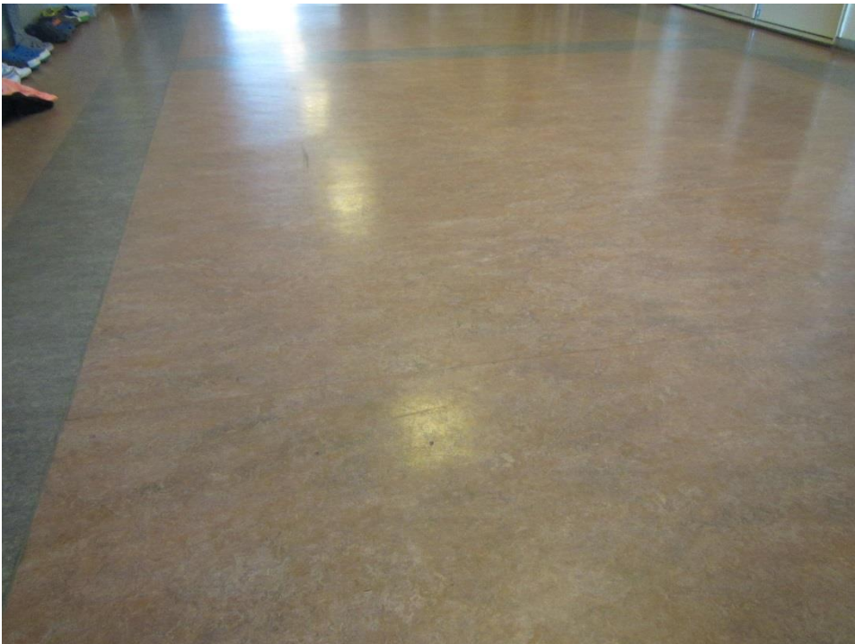
Kuva 31. Punertava marmorikuvioinen linoleumimatto sisältää haitallisen määrän sinkkiä (WMY 38).
