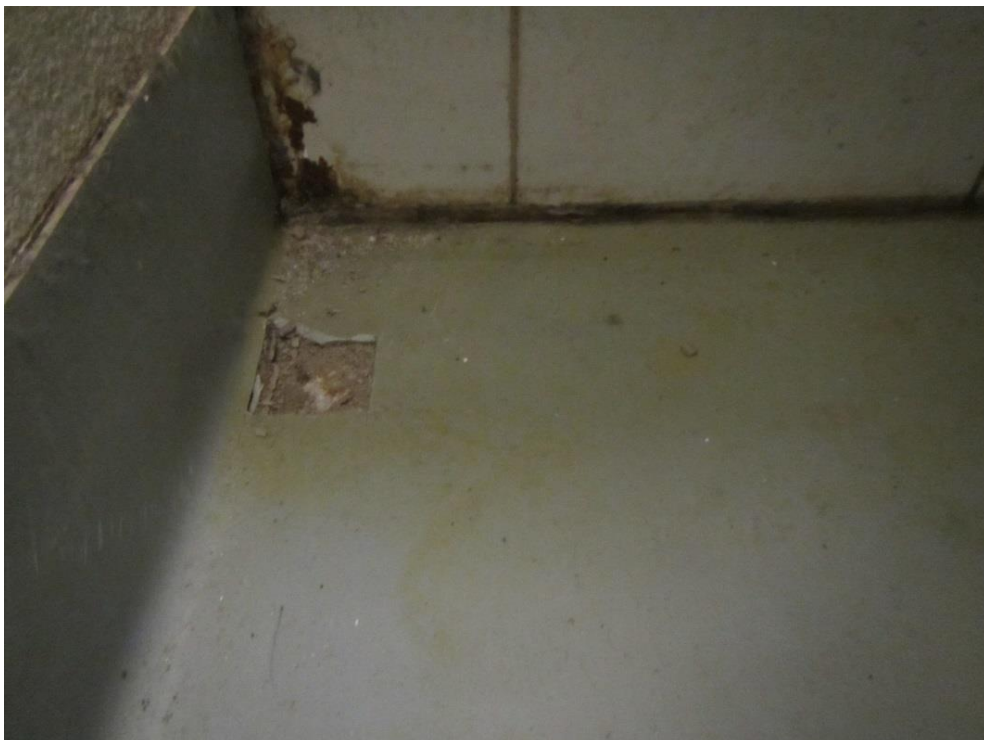
Kuva 25. Harmaa muovimatto sisältää haitallisen määrän sinkkiä (WMY 22).
