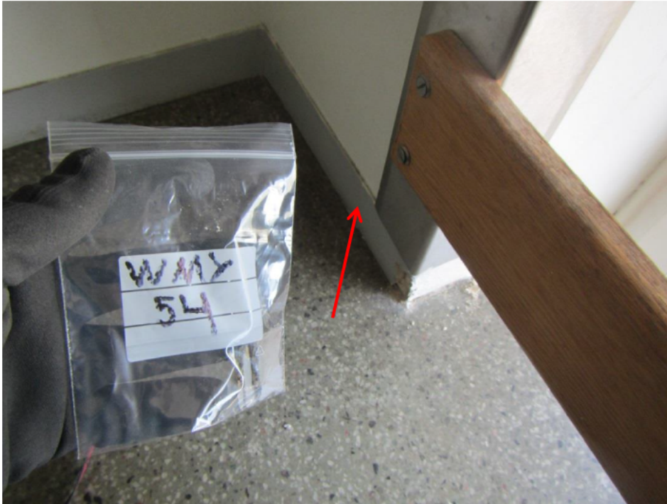
Kuva 34. Musiikkiopiston porrashuoneen jalkalista sisältää haitallisen määrän sinkkiä (WMY 54).
