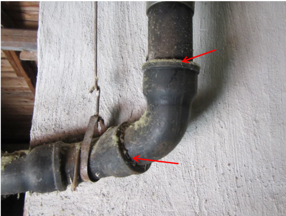
Kuva 37. Valurautaviemäreiden muhviiliitoksissa on todennäköisesti käytetty lyijyä.
