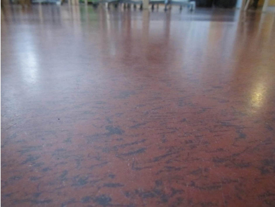
Kuva 30. Punainen mustapilkullinen linoleumimatto - / muovimatto sisältää haitallisen määrän sinkkiä (WMY 37).
