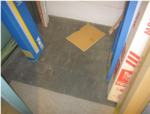
Kuva 11 Kohteessa oli varsin vähäinen määrä asbestipitoista Finnflex-vinyylilaattaa. ko. laatat olivat liimattu asbestipitoisella pikiliimalla.
