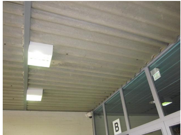
Kuva 8 Ulkopuolisissa sisäänkäynneissä oli asbestisementtilevyt katossa.
