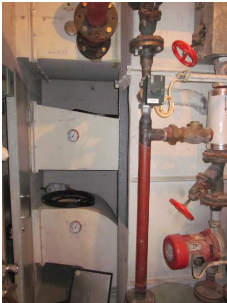
Kuva 9 IV-kanavien laippaliitoksissa oli asbestinauhatiivisteet.
