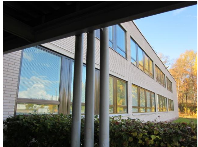
Kuva 14 Ulkopuolen harmaa maali sisälsi lyijyä.
