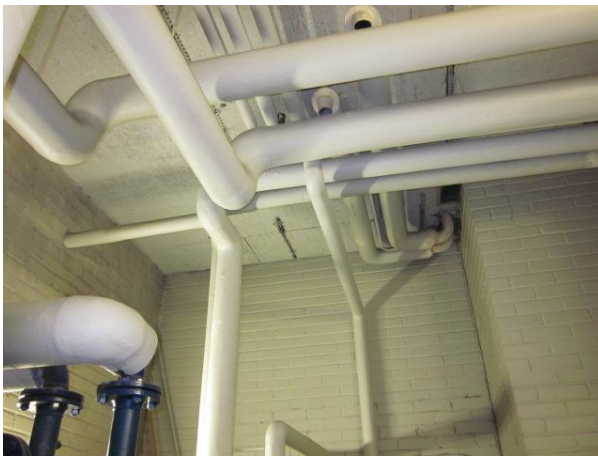
Kuva 1 Asbestipitoisia putkieristeitä. Putket olivat eristetty joko massalla tai pahvilla.
