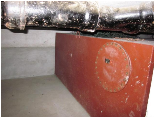
Kuva 13 Vanhoissa valurautaviemäreiden muhviliitoksissa on lyijyä joka tulee huomioida jätteen lajittelussa.
