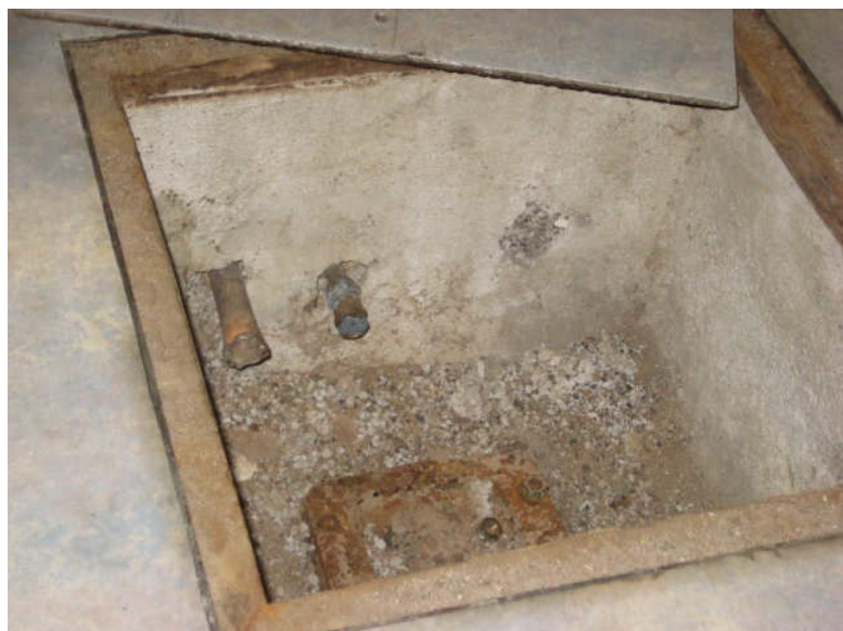
Kuva 2 Vanhoja pahvisia putkieristeitä oli lattiarakenteen sisässä.
