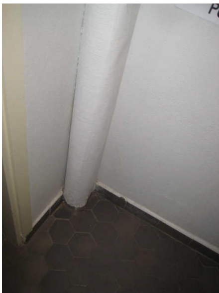
Kuva 1 Asbestipitoista putkieristettä WC:n nurkassa.
