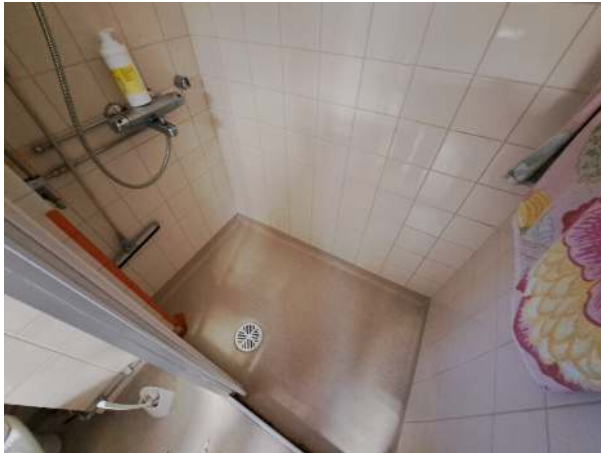
132. Asuinrakennuksen O10 A-asunnon kylpyhuoneen tekninen käyttöikä on loppuillaan.
