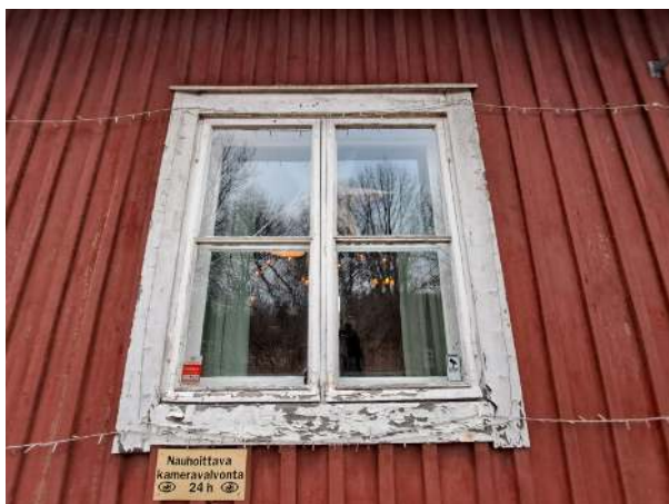
73. Ravintolarakennuksen O11 ikkuna ulkopuolelta. Ulkopuolen puuosissa havaittiin pinnoitteen kulumaa ja hilseilyä.
