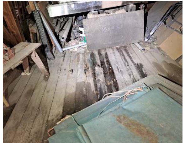
113. Lampolan O35 vesikaton vuotokohdassa kosteusjälkiä ja lahovaurioita myös ullakon lattiassa.
