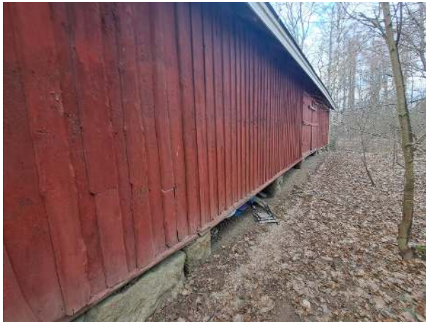
32. Kuusiladon O30 perustuksissa havaittavissa painumaa.
