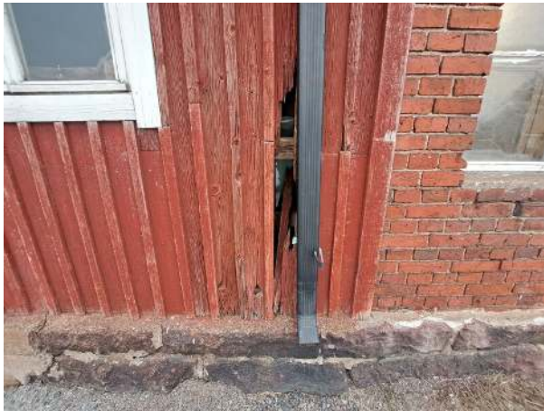
63. Lampolan O35 julkisivuverhouksen vaurioita.
