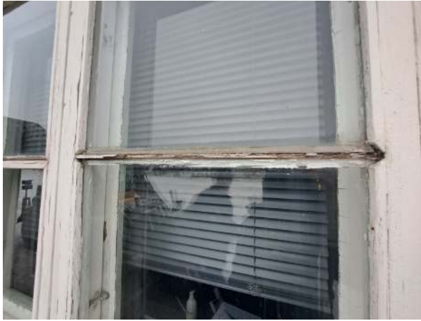
81. Lampolan O35 ikkunoiden lasituslistat paikoin irronneet.
