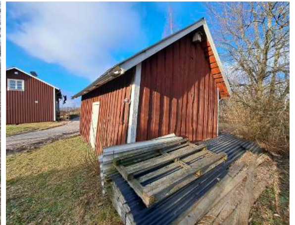
33. Talousrakennus 997 on painunut/kallellaan.
