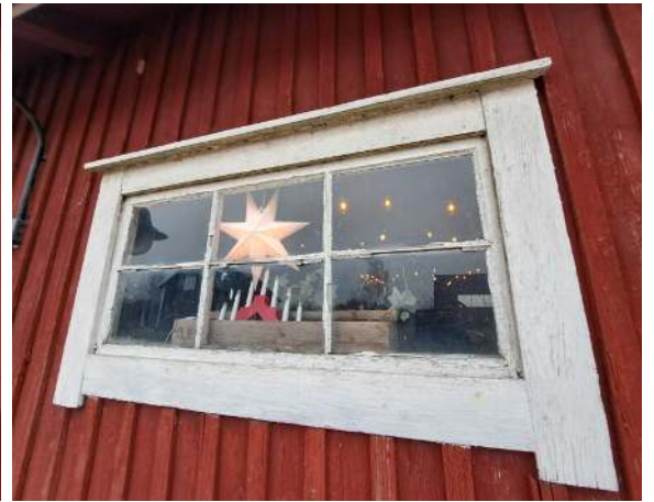
84. Keskusvarasto O31 ikkunaa. Ulkopuolen puuosissa pinnoitteen hilseilyä.
