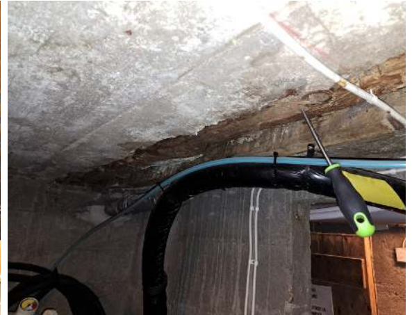
46. Ravintolarakennuksen O11 kellarikerroksen välipohjarakenteen hirsipalkeissa havaittiin lahovaurioita.
