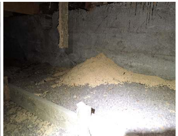
37. Asuinrakennuksen O10 alapohjatilassa havaittiin paikoin sahanpurukasoja.
