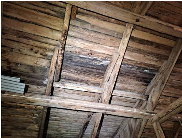
112. Lampolan O35 vesikaton alusrakenteiden kosteusjälkiä.
