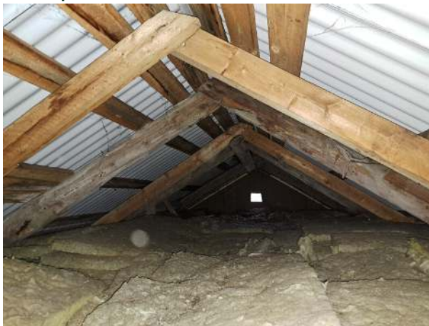
108. Asuinrakennuksen O12 yläpohjatilaa, vesikaton alla ei ole aluskatetta.
