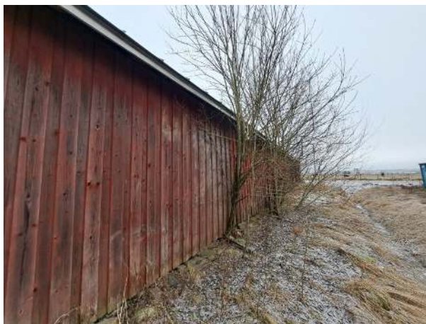
8. Kasvillisuus on liian lähellä rakenteita.
