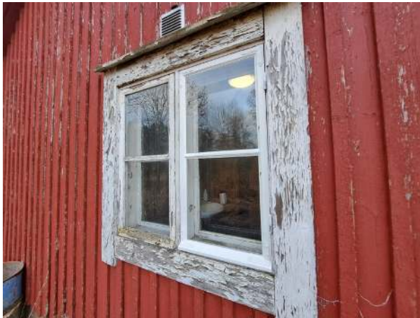
77. Saunarakennuksen O17 ikkuna ulkopuolelta. Ulkopuolen puuosissa pinnoitteen hilseilyä.
