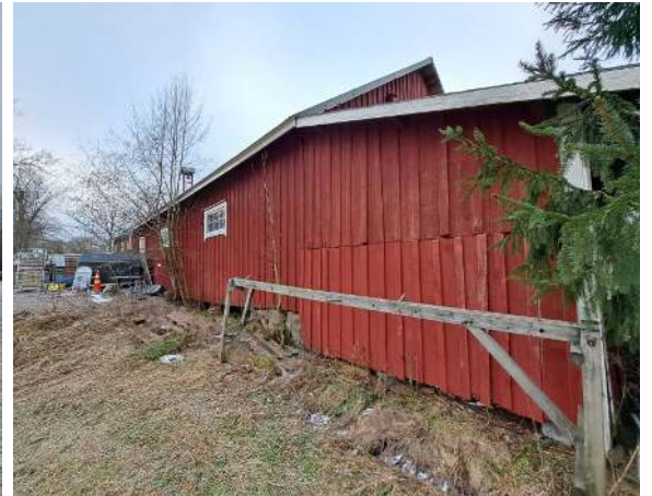
35. Keskusvaraston O31 perustuksissa havaittavissa painumaa.
