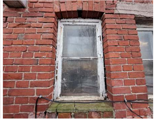
82. Lampolan O35 ikkunaa ulkopuolelta, ikkuna heikossa kunnossa.
