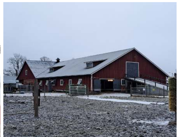
111. Lampolan O35 vesikattoa, katolle ei ole kulkuyhteyttä.
