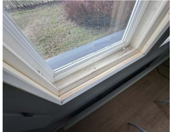
76. Asuinrakennuksen O12 ikkunan karmivälin puuosissa havaittiin pinnoitteen lohkeilua.
