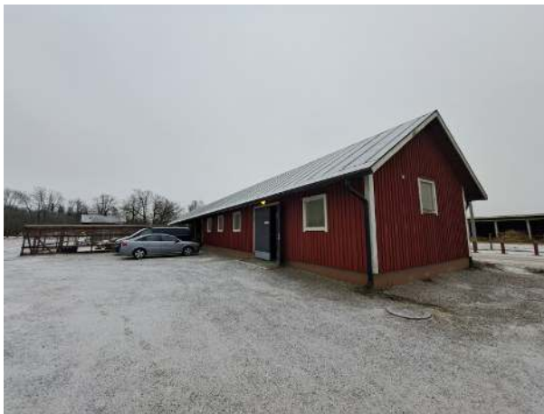
114. Eläinsuoja/maneesi O37 vesikattoa.
