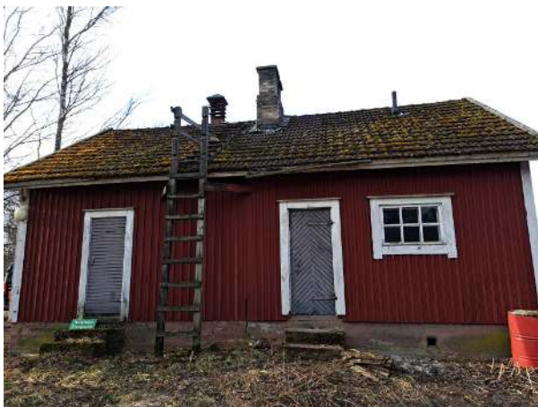
110. Saunarakennuksen O17 vesikate on heikossa kunnossa.
