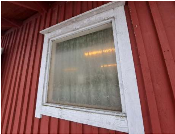
83. Eläinsuojan/maneesin O37 ikkunoiden ulkopuolen puuosissa on likaantumista ja kulumaa.
