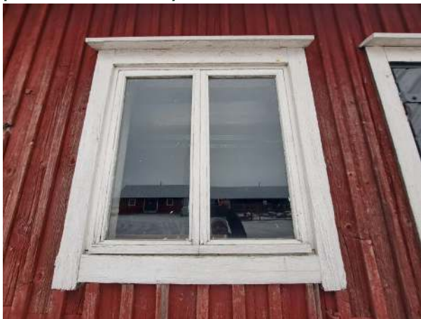
79. Lampolan O35 ikkuna ulkopuolelta. Ulkopuolen puuosissa pinnoitteen halkeilua ja hilseilyä.
