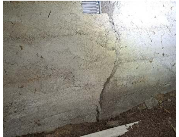
21. Asuinrakennuksen O10 sokkelin halkeama.
