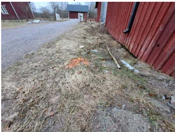
7. Keskusvaraston O31 vierustalla maanpinta kallistaa rakennukseen päin.
