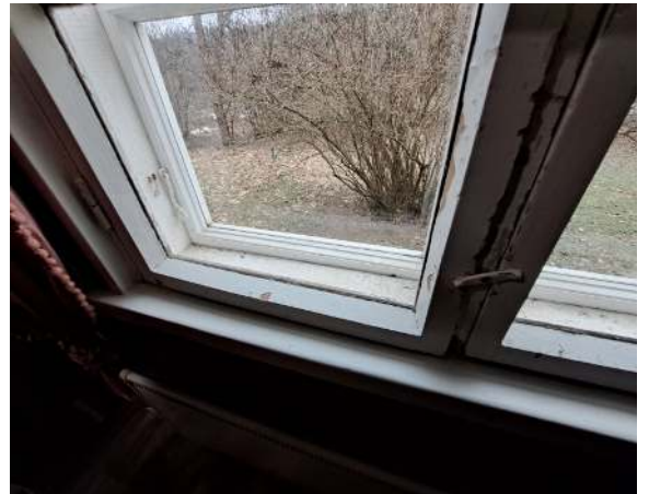
72. Asuinrakennuksen O10 ikkunan sisäpuolteen ja karmivälin puuosissa havaittiin pinnoitteen halkeilua ja lohkeilua.
