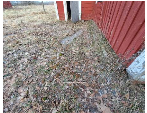
4. Saunarakennuksen O17 vierustaa, sokkelikorkeus on paikoin niukka.
