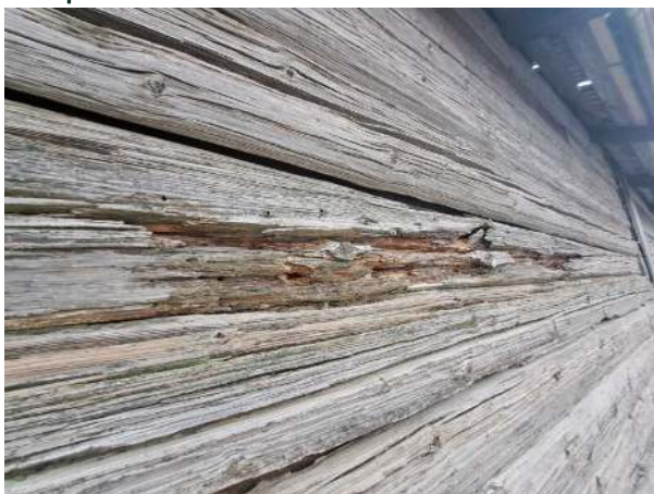
49. Ladon O20 hirsirungossa havaittiin runsaasti lahovaurioita.
