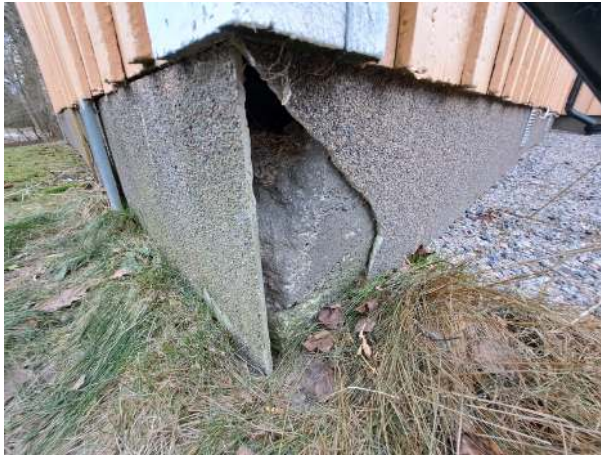
20. Asuinrakennuksen O10 levyverhouksessa havaittiin runsaasti halkeamia ja vaurioita.
