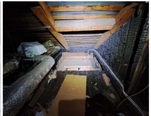
44. Ravintolarakennuksen O11 runkorakenteissa havaittiin hiiltymiä yläpohjatilassa.
