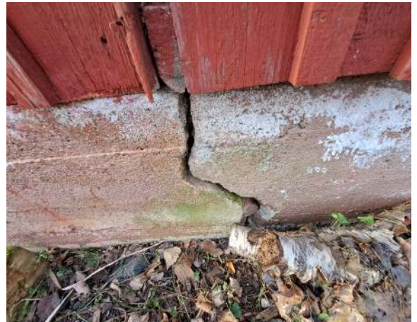
27. Saunarakennuksen O17 sokkelin halkeamia.
