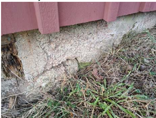
24. Asuinrakennuksen O12 sokkelin vaurioita.
