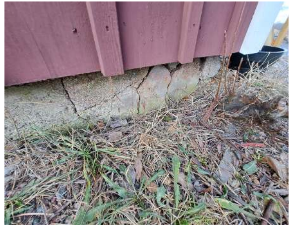
23. Asuinrakennuksen O12 sokkelin vaurioita.
