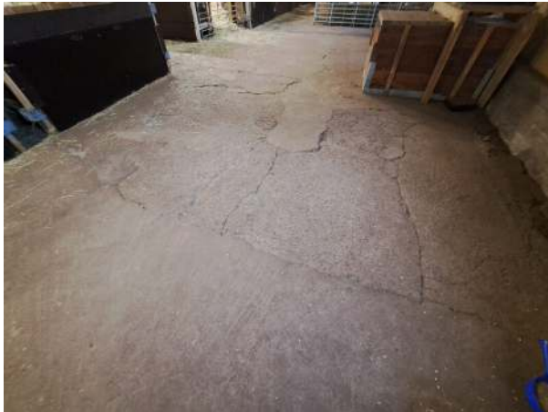
40. Lampolan O35 alapohjan halkeamia.
