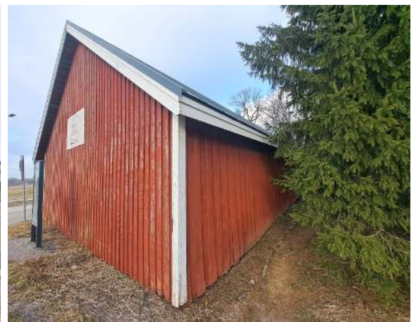
9. Kasvillisuus on liian lähellä rakenteita.
