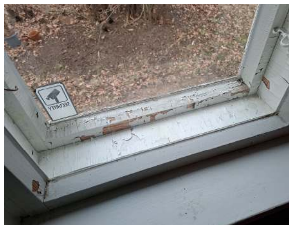
74. Ravintolarakennuksen O11 ikkunan sisäpuolteen ja karmivälin puuosissa havaittiin pinnoitteen halkeilua ja lohkeilua.
