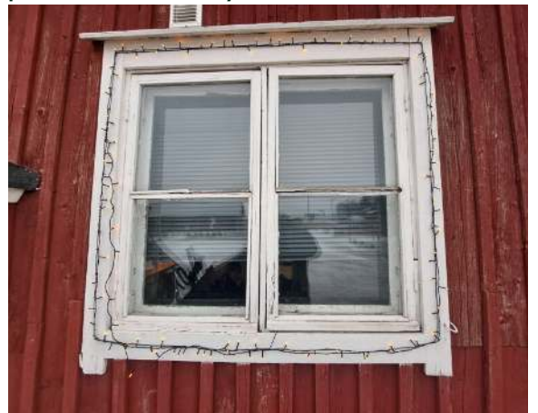
80. Lampolan O35 ikkuna ulkopuolelta. Ulkopuolen puuosissa pinnoitteen halkeilua ja hilseilyä.
