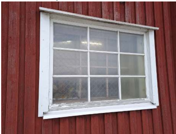
85. Verstas/katos O19 ikkunaa. Ulkopuolen puuosissa pinnoitteen hilseilyä.
