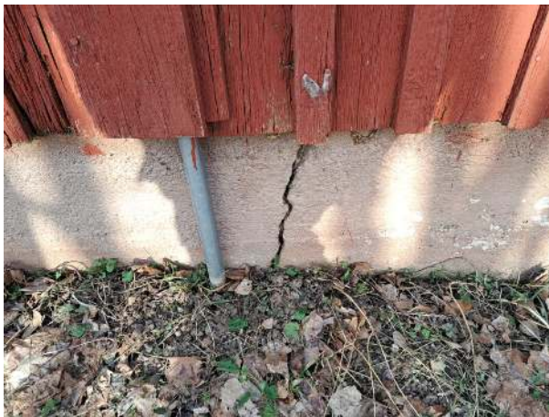
28. Saunarakennuksen O17 sokkelin halkeamia.
