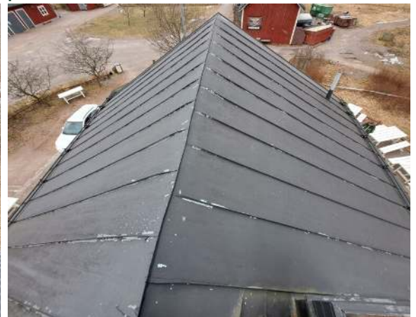
105. Ravintolarakennuksen O11 vesikatteen pinnoite hilseilee.
