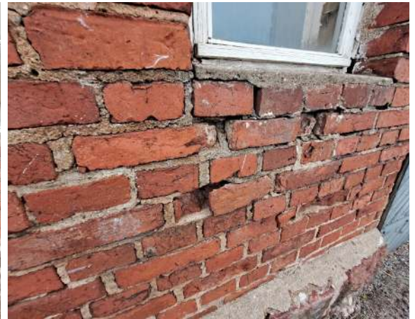
64. Lampolan O35 julkisivuverhouksen vaurioita.
