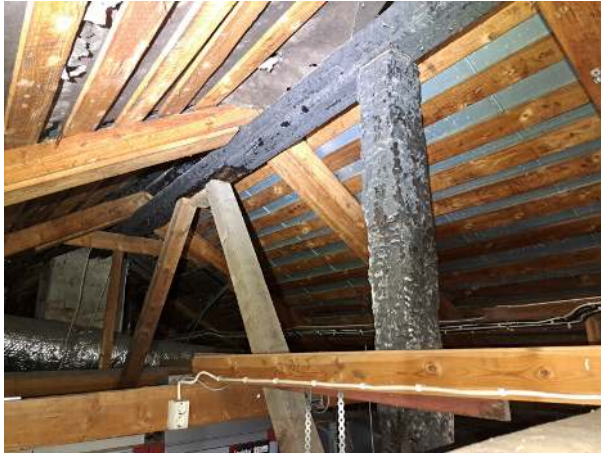
45. Ravintolarakennuksen O11 runkorakenteissa havaittiin hiiltymiä yläpohjatilassa.
