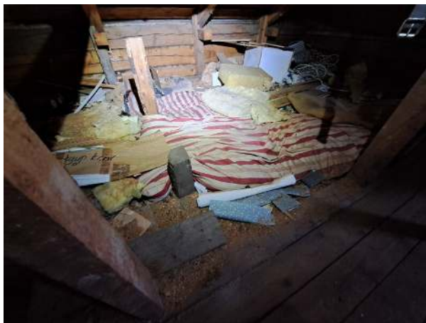
102. Asuinrakennuksen O10 yläpohjan eristekerrosten päällä on tekstiilejä ja irtaimistoa, joka suositellaan poistamaan.
