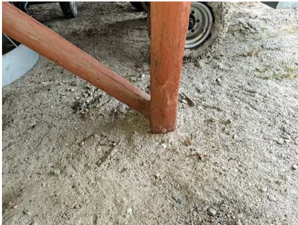
53. Katoksen O20 pilarit on paikoin tuettu suoraan maata vasten.
