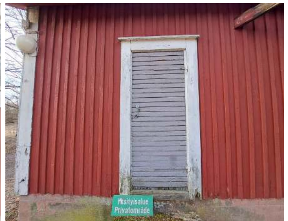
93. Saunarakennuksen O17 ikääntynyt ulko-ovi.
