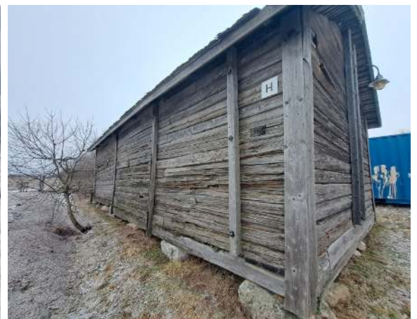
50. Ladon O20 hirsirungossa havaittiin runsaasti lahovaurioita.
