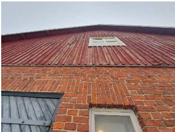
65. Lampolan O35 julkisivuverhouksen vaurioita.
