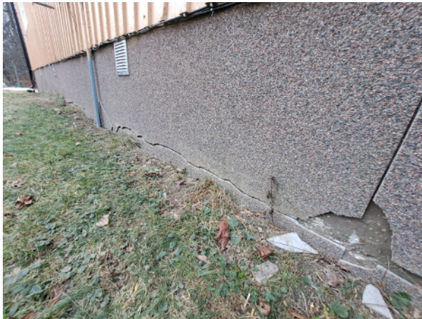
22. Asuinrakennuksen O10 levyverhouksessa havaittiin runsaasti halkeamia ja vaurioita.
