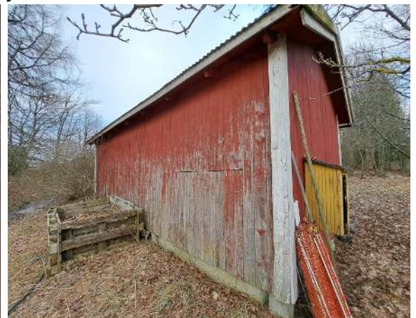
68. Varaston O29 julkisivuverhoukus on välttävissä kunnossa, pinnoite hilseilee ja alaosissa paikoin lahovaurioita.
