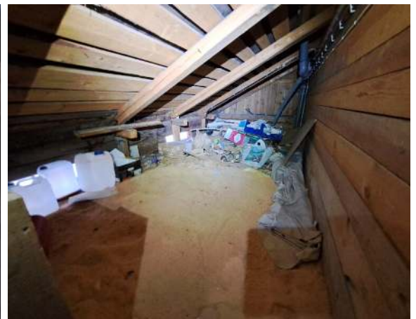
103. Asuinrakennuksen O10 yläpohjan eristekerrosten päällä on tekstiilejä ja irtaimistoa, joka suositellaan poistamaan.
