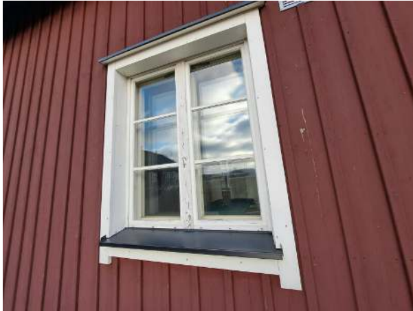
75. Asuinrakennuksen O12 ikkuna ulkopuolelta. Ulkopuolen puuosissa havaittiin pinnoitteen hilseilyä.
