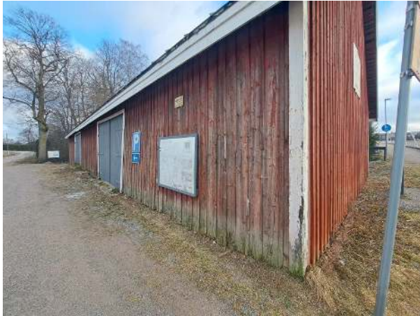
69. Kuusiladon O30 julkisivuverhous on heikossa kunnossa. Alaosissa lahovaurioita ja puuosissa haristumaa.
