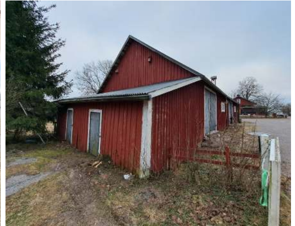
70. Keskusvaraston O31 julkisivuverhous on välttävissä-heikossa kunnossa. Pinnoite hilseilee, puuosissa haristumaa ja alaosissa paikoin lahovaurioita.
