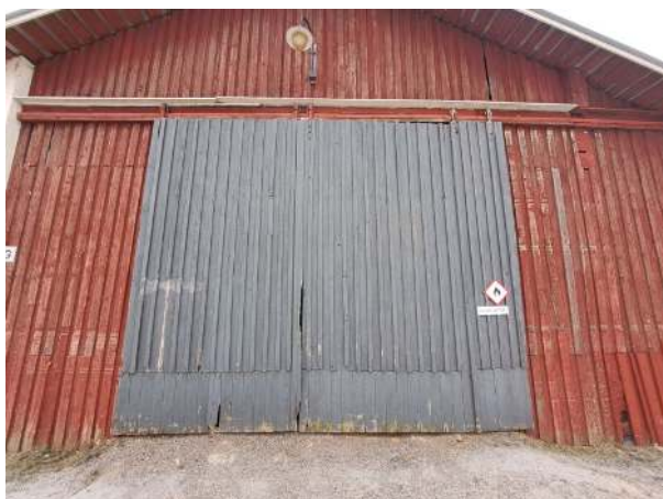
98. Verstaan/katoksen O19 liukuovi on välttävässä kunnossa.
