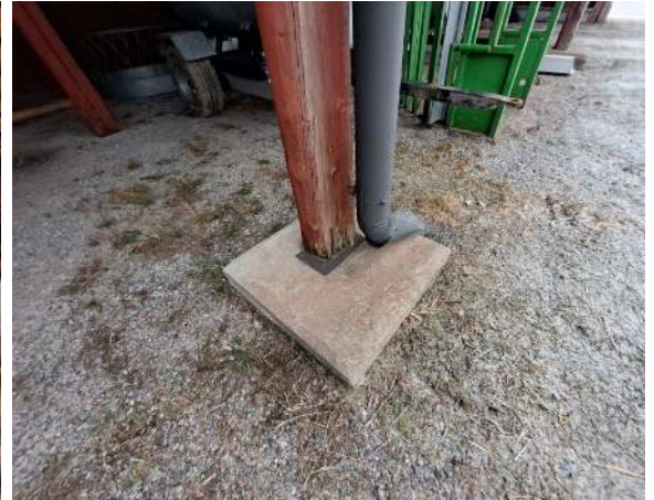
52. Katoksen O20 pilarin alaosassa havaittiin lahovaurio.
