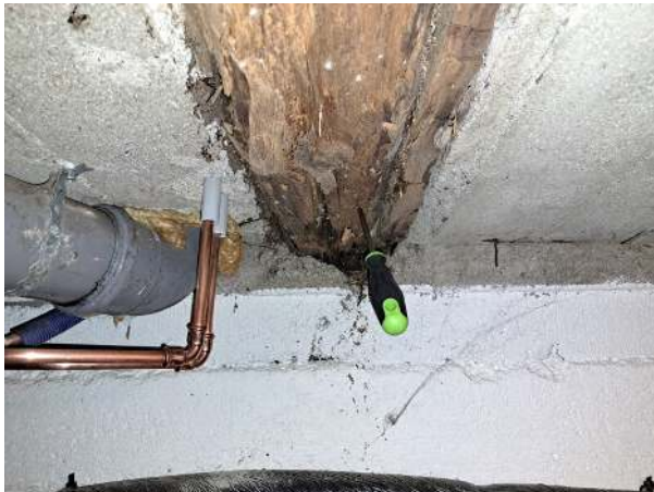
47. Ravintolarakennuksen O11 kellarikerroksen välipohjarakenteen hirsipalkeissa havaittiin lahovaurioita.
