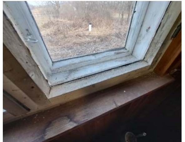
78. Saunarakennuksen O17 ikkunan karmivälin puuosissa havaittiin pinnoitteen hilseilyä.
