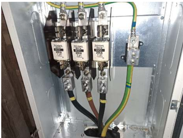
189. Liittymiskaapeli ja päävarokkeet.
