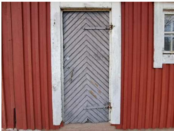
92. Saunarakennuksen O17 ikääntynyt ulko-ovi.
