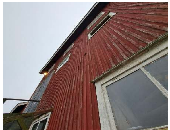
39. Kuivaamon O03 julkisivu on välttävässä kunnossa.
