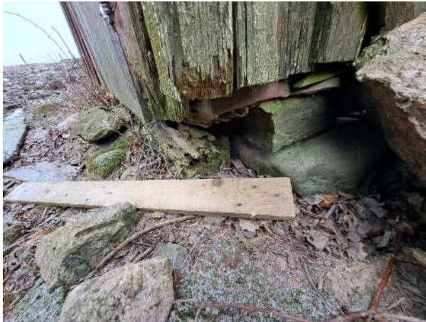
29. Kellarimäen talon 004 puurungossa havaittiin lahovaurioita.
