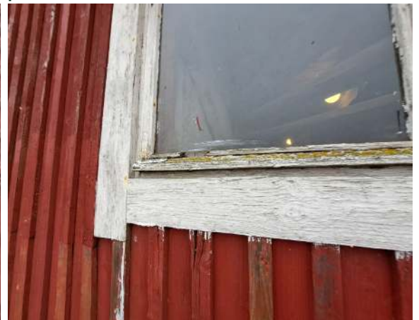
47. Kuivaamon O03 ikkunoiden lasituslistat paikoin irronneet.
