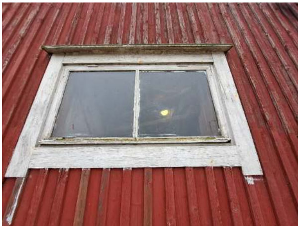
46. Kuivaamon O03 ikkuna ulkopuolelta. Ulkopuolen puuosissa pinnoitteen halkeilua ja hilseilyä.
