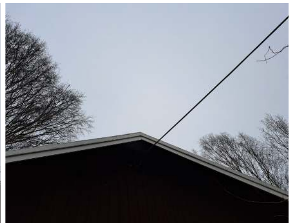
80. Asuinrakennuksesta 4, saman "tontin" talousrakennukseen asennettu nousukaapeli.
