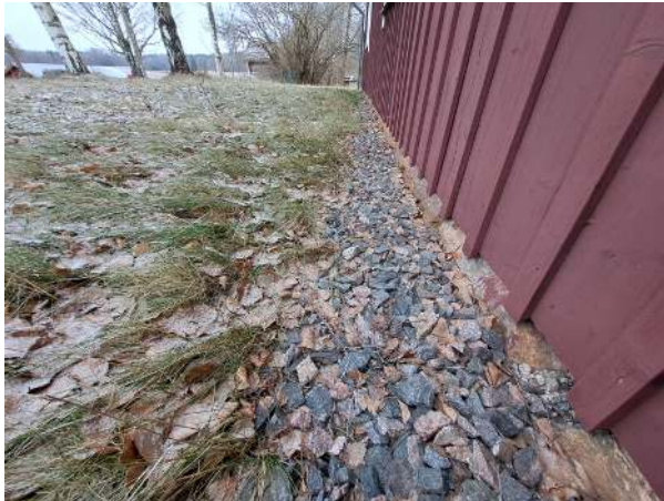
1. Asuinrakennuksen 002 tien puoleista seinustaa, sokkelikorkeus on niukka ja maanpinta kallistaa loivasti rakennukseen päin.
