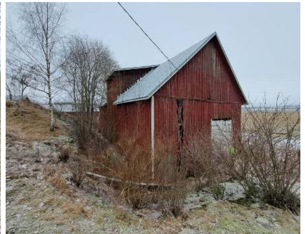
13. Kasvillisuutta liian lähellä rakennusta.
