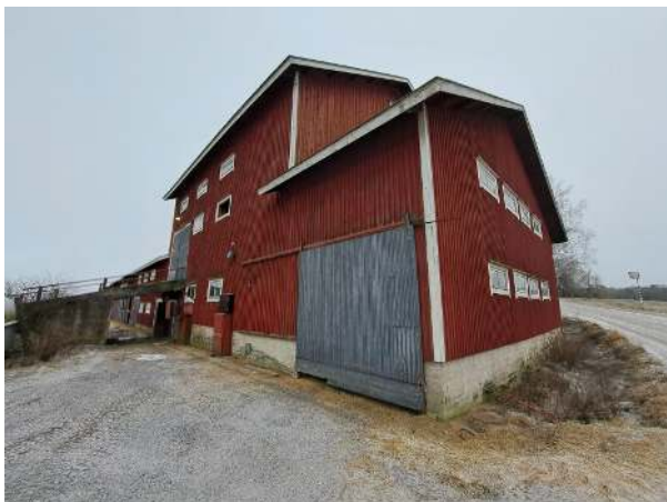
38. Kuivaamon O03 julkisivu on välttävässä kunnossa.
