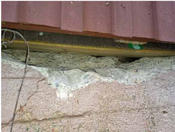
36. Kellarimäen saunan O34 julkisivuverhouksen takana on tuuletusrako.
