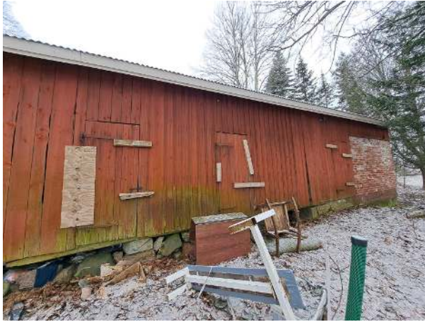
40. Niskalan talousrakennuksen julkisivu on heikossa kunnossa.
