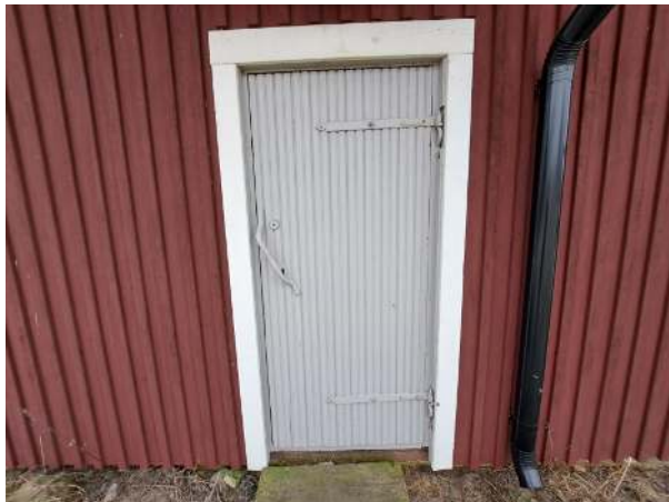
50. Kellarimäen saunan O34 ulko-ovi on tyydyttävässä kunnossa.
