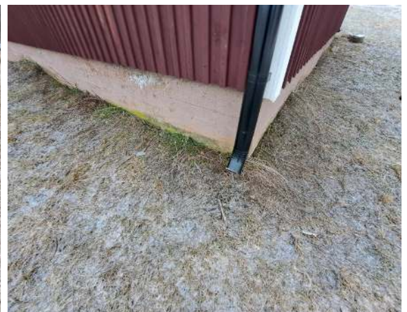
4. Kellarimäen saunan 034 kattovedet johdetaan syöksytorstista suoraan maaperään.
