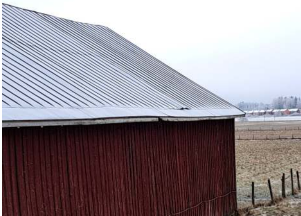
60. Kuivaamon O03 vesikatolla havaittiin muutamia auenneita peltisaumoja.
