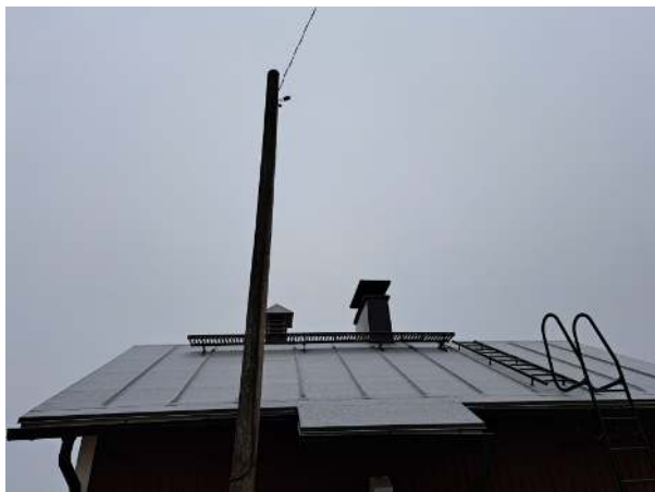
79. Saunarakennuksen nousu / liittymiskaapeli.
