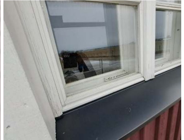
45. Kellarimäen saunan O34 ikkunan ulkopuolen puuosissa havaittiin pinnoitteen halkeilua.
