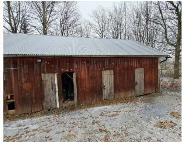
55. Niskalan talousrakennuksen ovet ovat heikossa kunnossa.
