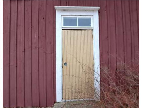
49. Asuinrakennuksen O02 takapihan ulko-ovi, ovi roikkuu.
