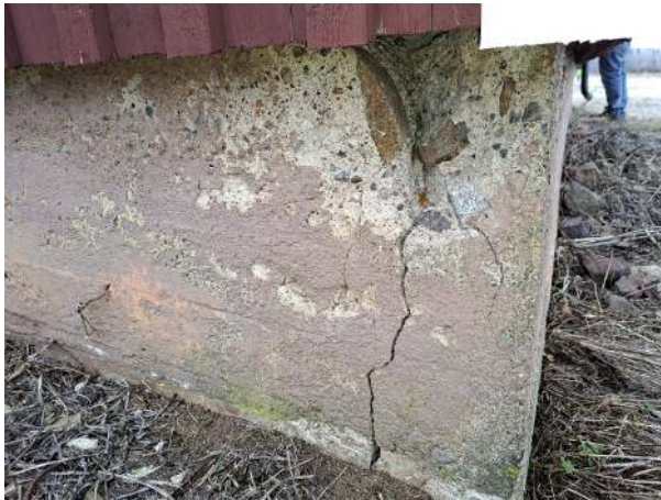
20. Kellarimäen saunan O34 sokkelin lohkeama ja halkeama.
