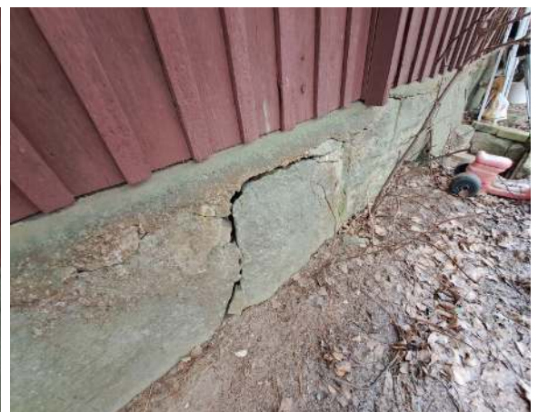
19. Asuinrakennuksen 002 sokkeliä, saumat paikoin epätiivit.
