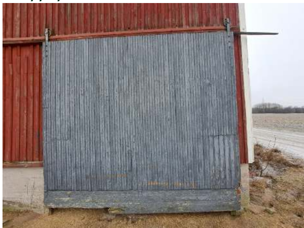
52. Kuivaamon liuku-ovi on heikossa kunnossa.
