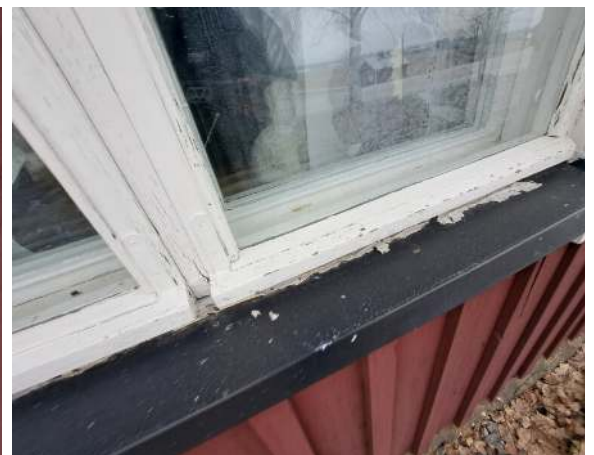
43. Asuinrakennuksen 002 ikkuna ulkopuolen puuosissa havaittiin pinnoitteen halkeilua ja hilseilyä.
