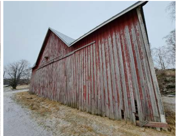
37. Kellarimäen talon O04 julkisivu on heikossa kunnossa.
