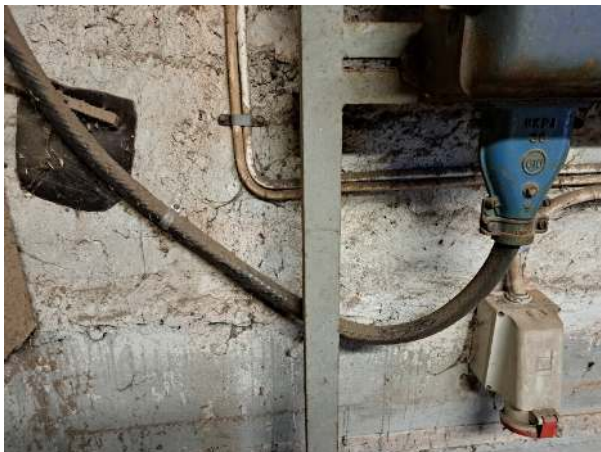
84. Kuivurirakennuksen todella ikäänntynyt liittymiskaapeli.
