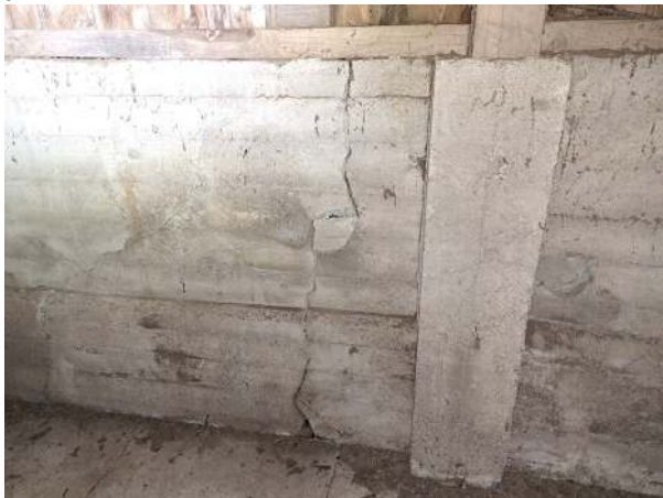
24. Kuivaamon 003 sokkelin halkeamaa.
