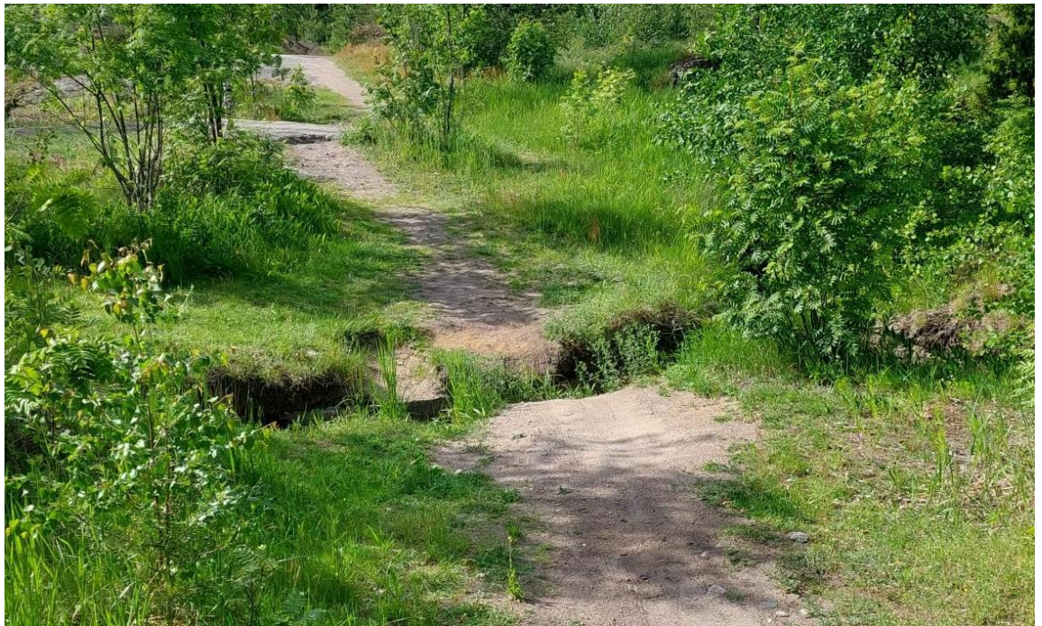
Kuva 31. Pääreitti ylittää alueen länsiosassa haudan vaarallisesti ja haudan reunat ovat kuluneet voimakkaasti. Paikalle rakennetaan kaivannon ylittävä silta.
